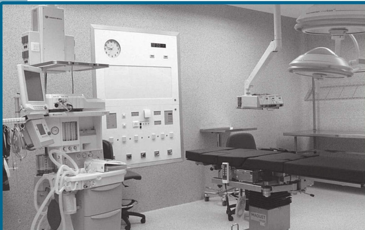
Quirófano, ejemplo de sala del grupo 2 a.
