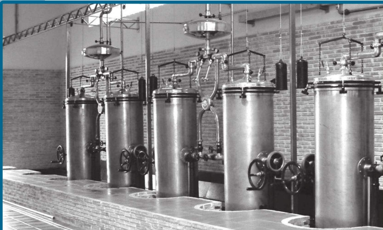
Espacio dispuesto para destilería de bebidas alcohólicas.
